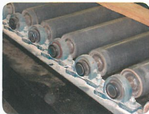
Túlmelegedett szállítószalag csapágy
